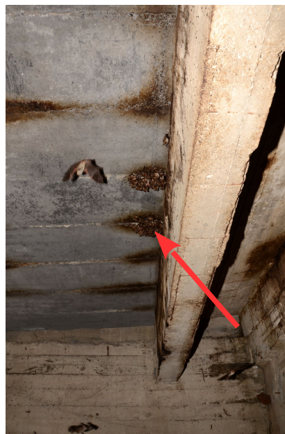
Ilustracja 9. Zabrudzenia w szczelinach między płytami stropowymi obrazujące skalę użytkowania obiektu przez nietoperze (komora 16).
