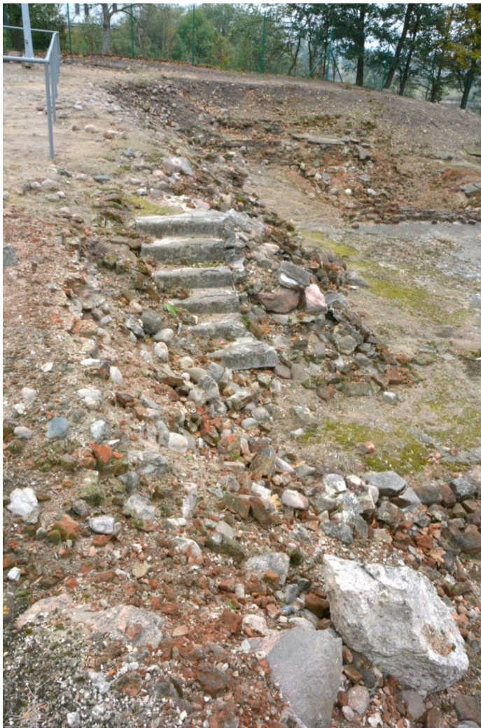
Fot. nr 8. Stan zachowania przed konserwacją.
