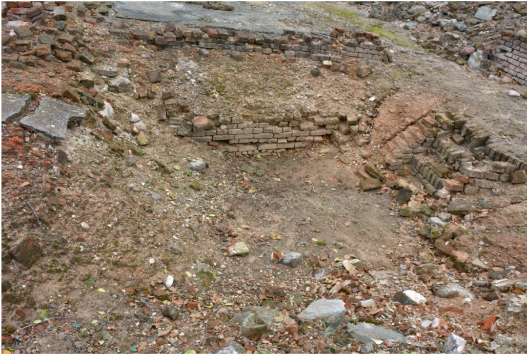
Fot. nr 27. Stan zachowania przed konserwacją.
