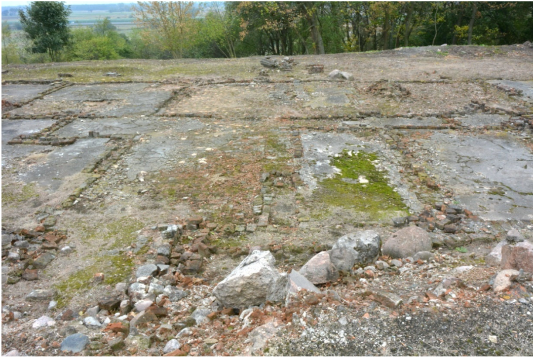
Fot. nr 7. Stan zachowania przed konserwacją.
