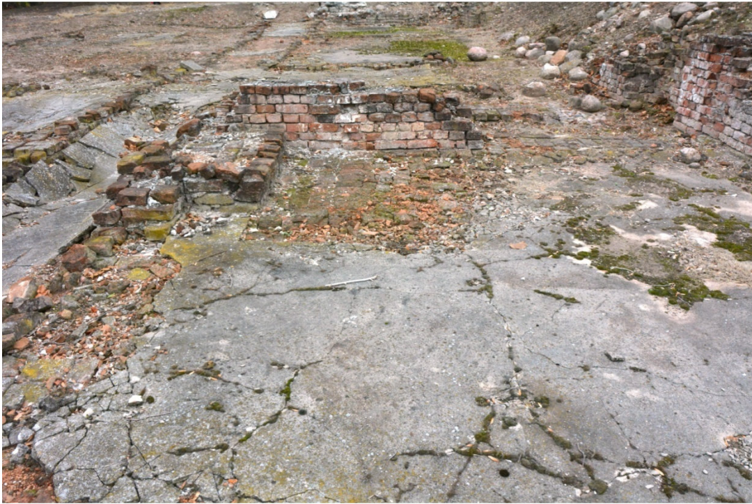
Fot. nr 21. Stan zachowania przed konserwacją.
