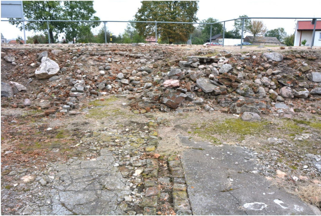
Fot. nr 23. Stan zachowania przed konserwacją.
