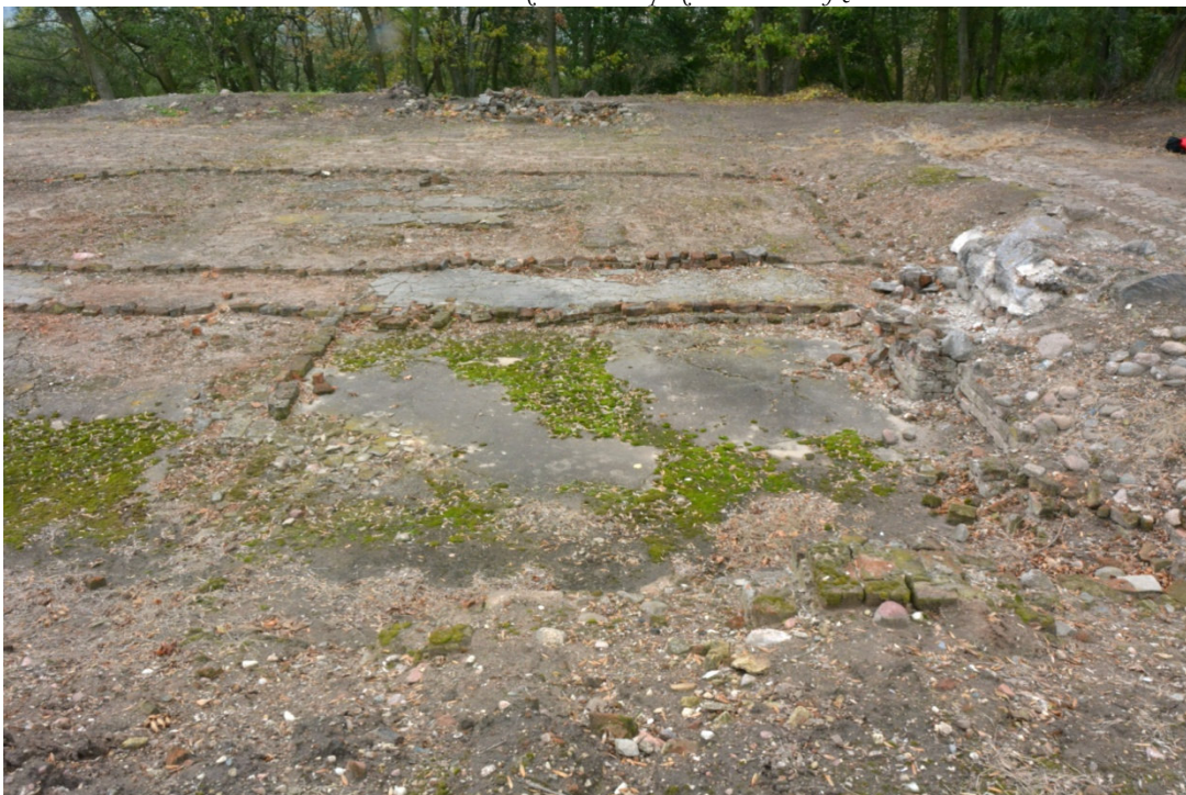
Fot. nr 12. Stan zachowania przed konserwacją.
