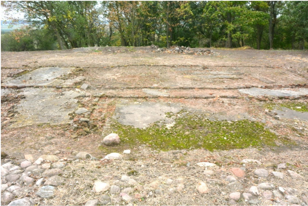
Fot. nr 11. Stan zachowania przed konserwacją.
