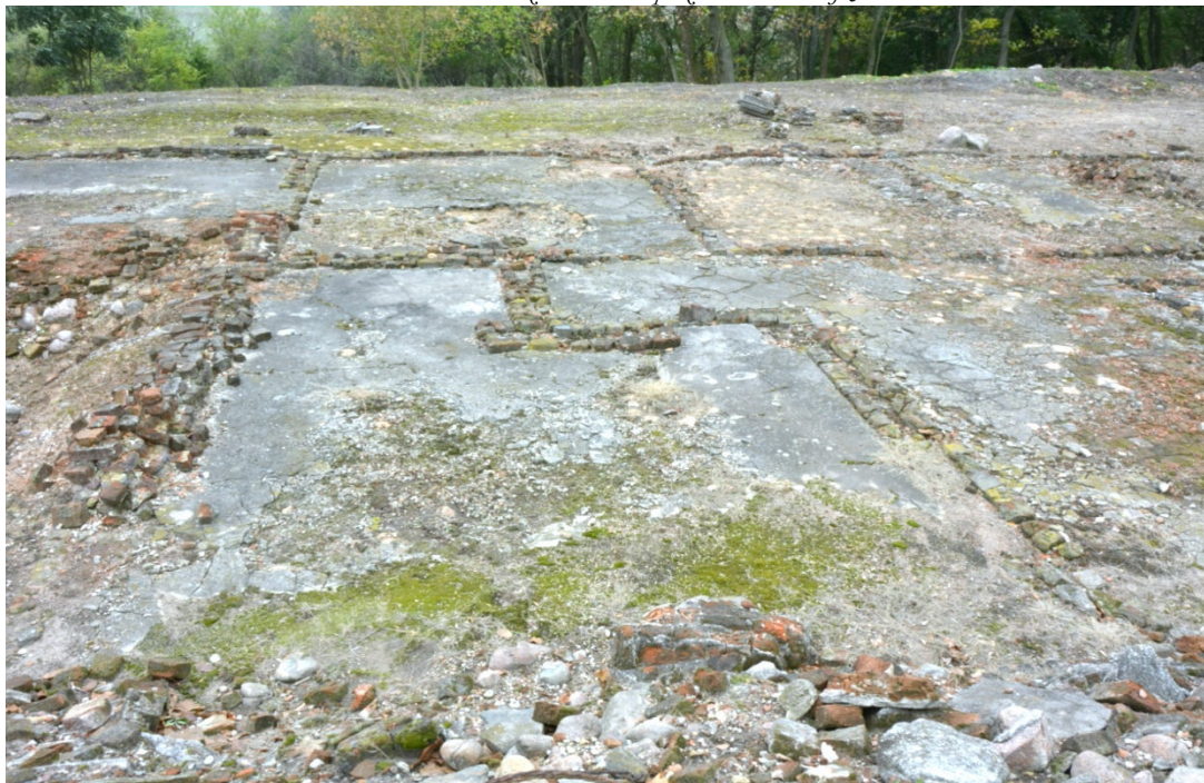
Fot. nr 6. Stan zachowania przed konserwacją.
